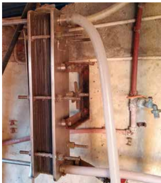
Imagen 2. Intercambiador de calor de placas
