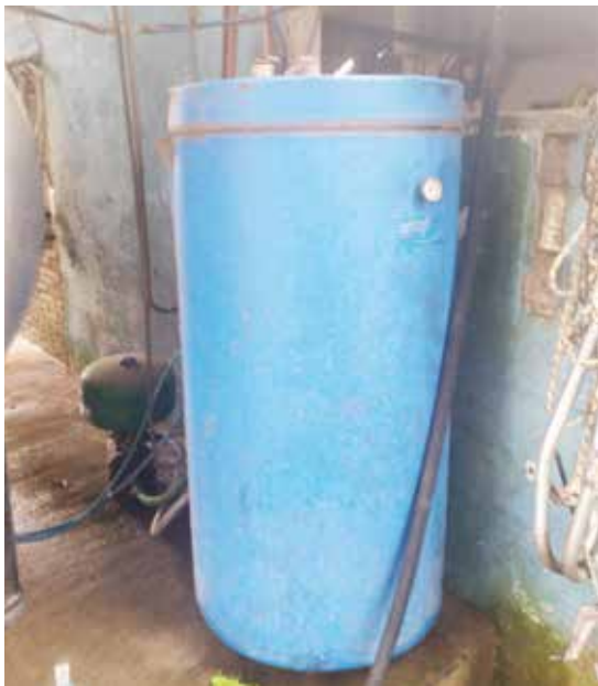
Imagen 3. Tanque recuperador de calor en funcionamiento
