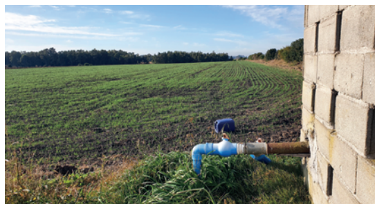
Imagen 3. Toma de la instalación de bombeo para riego
