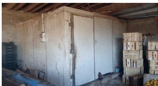
Imagen 1. Cámara de frío de isopanel
