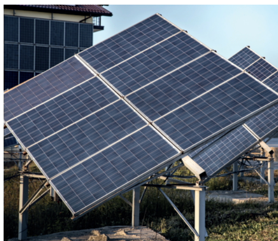
Imagen 4. Planta solar fotovoltaica de mediano porte
