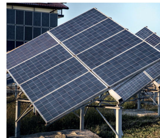
Imagen 4. Planta solar fotovoltaica de mediano porte
