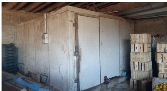
Imagen 1. Cámara de frío de isopanel
